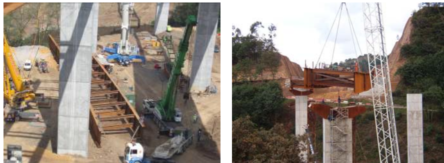
Figura 6. Izquierda - Viaducto Nora 1. Tramo preparado para su izado. Derecha - Viaducto Nora 2. Tramo montándose con una grúa
